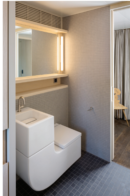
Img. 32 Toilet Roca
