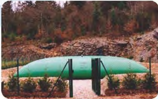
Citerne de 240 m 3 pour la défense incendie d'une commune
