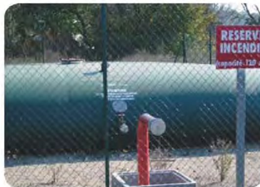
Citerne de 120m 3 avec vidange enterrée
