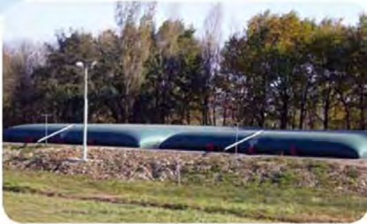
2 x 400 m 3 de récupération d'eau pluviale pour usage industriel
